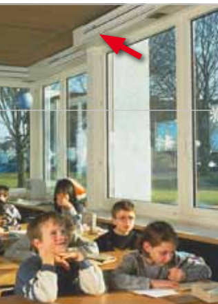
Collège équipé de ventilateurs insonorisants AEROMAT VT-WRG avec récupération de chaleur (vue côté intérieur)
